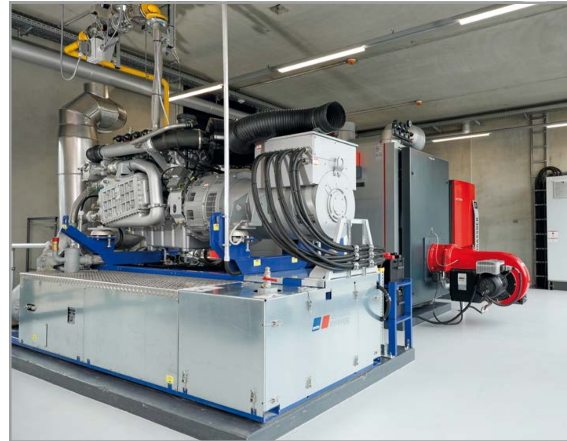
Blick in die Energiezentrale Bildquelle: Alois Müller GmbH/Marco Lambart
