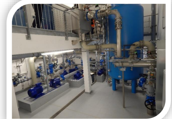
Pumpwerk eines Wasserversorgers
